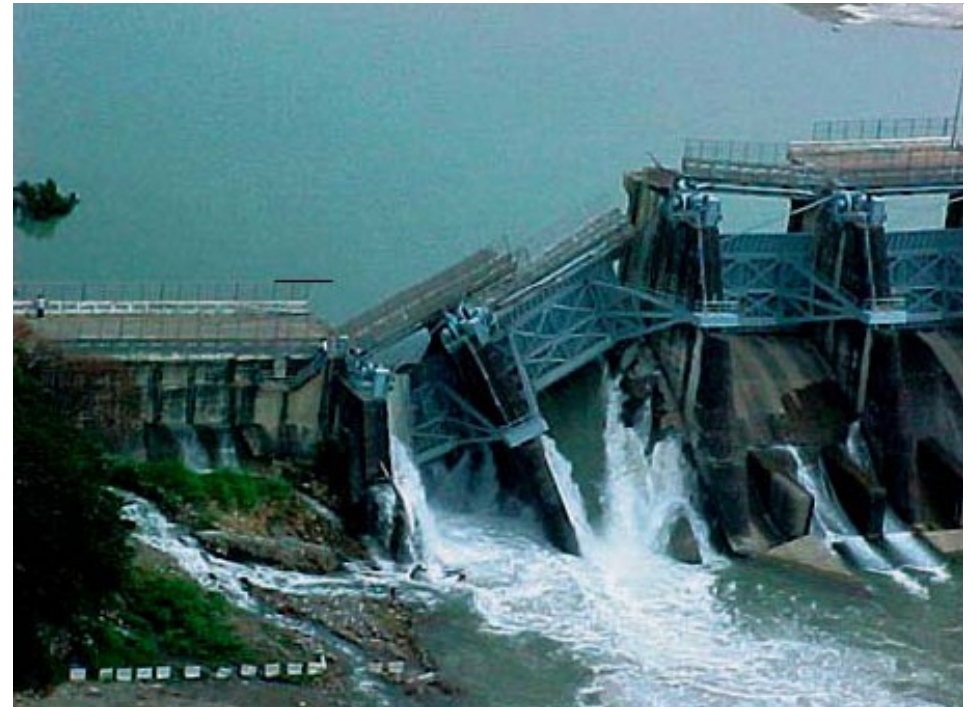
Rupture du barrage de Shih-Kang (Taiwan) 1999
